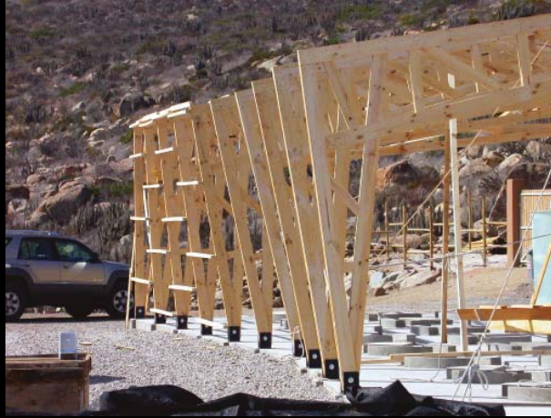
← Magazie, vedere din timpul procesului de montare a structurii de lemn. Shed, view during the assembly process, showing the bare timber structure.
