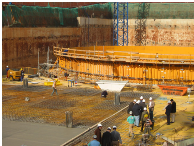
Diferentes momentos del desarrollo de las tareas correspondientes a la ejecución de las losas.
