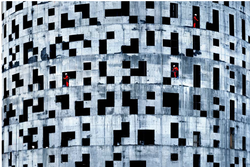
Tramo de muro ejecutado donde se hacen patentes los morteros de reparación
